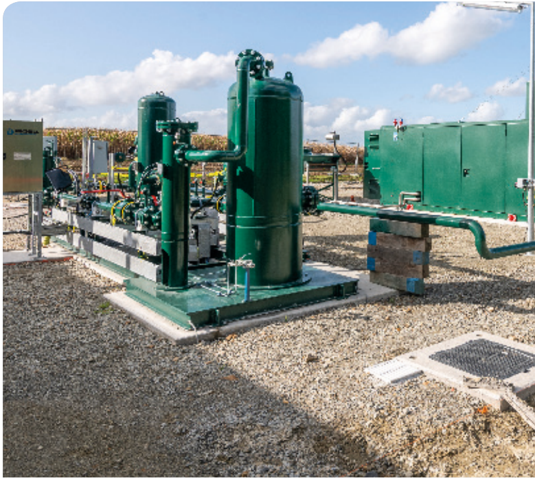
Station de rebours de Pontry
