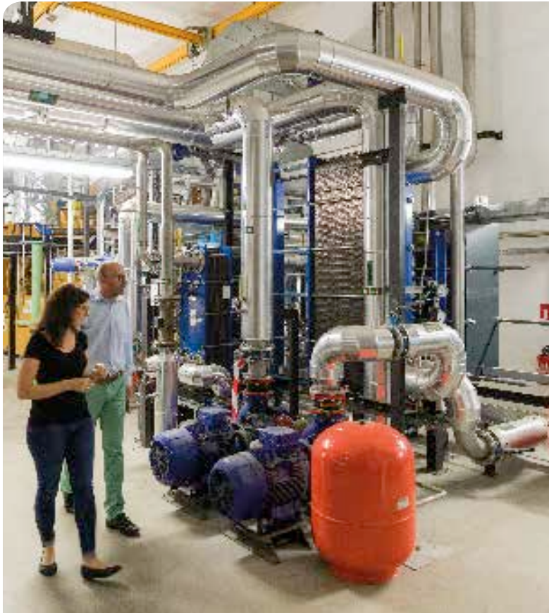
Visite des installations de gaz des serres de la Piogerie
