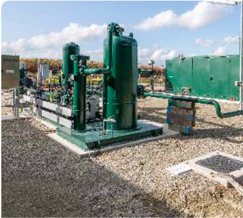
Station de rebours de Ponivy
