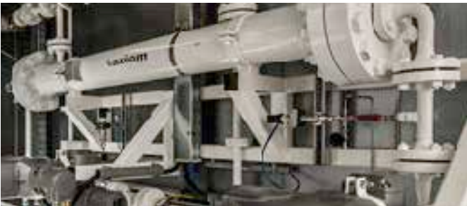
Séparation GN et H 2 par membrane polymère
